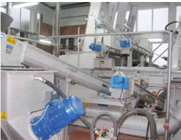
Kein Problem stellen komplizierte Förderwege mit unterschiedlichen Einwurfsituationen dar.
