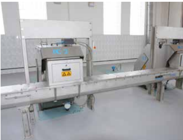
Förderung von Rechengut mit zwei parallel einwerfenden Rechen.
